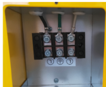
Figura 10 - Al retirar la cubierta del cableado se exponen los cables. Al conectar a tierra un cable de 2 conductores, el cable blanco debe marcarse como negro.
